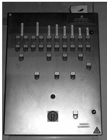
Foto 5 Kontrollgerät der Dosierstation.
