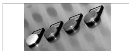
Foto 6 Kontrollleuchten in der Reinigungszone.
